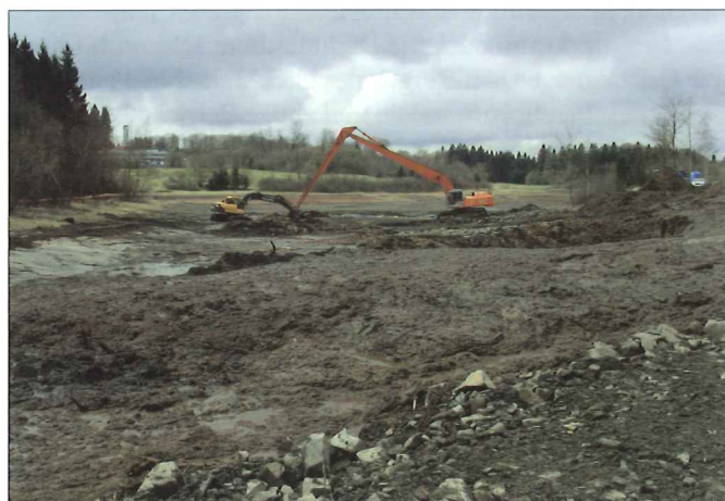
Für das Aufnehmen und Umsetzen der belasteten Böden hat sich der Einsatz von Langarmbaggern gut bewährt (Mittlerer Pfauenteich)
